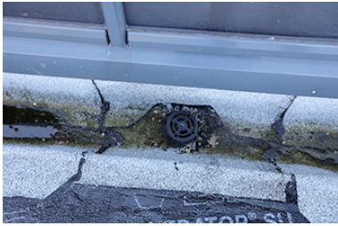
Eine der Quellen für Undichtigkeiten innerhalb des Gebäudes.
