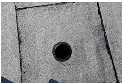
Opferplatte: Für den Fall einer Undichtigkeit wurde der Bereich von 1 x 1 Meter rund um den Gullyeinlauf gesondert abgedichtet.
