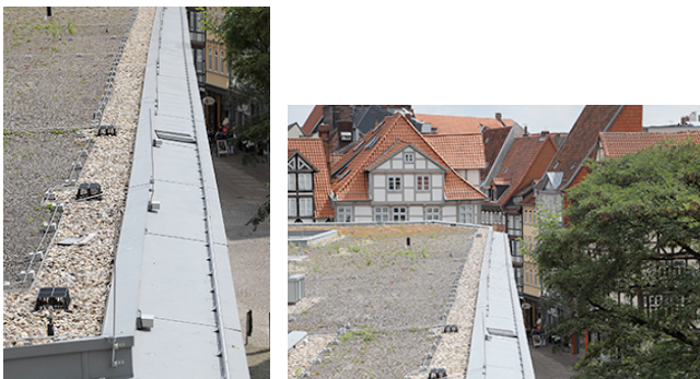
Speien auf die neue Zinkblechabdeckung: Die in Reihe angeordneten Sita Turbo Attikagullys.
