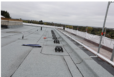
Arbeiten perfekt zusammen: Die SitaTurbogullys, von denen insgesamt 40 Stück verbaut wurden.
