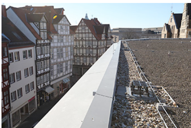
Wasserwächter an der Attika: Die in Reihe verbauten SitaTurbo Rechteckgullys.
